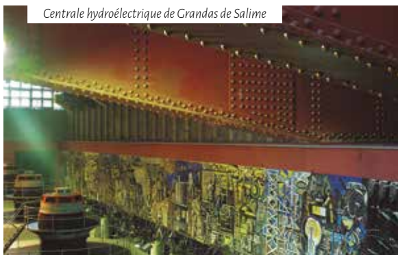
Centrale hydroélectrique de Grandas de Salime
